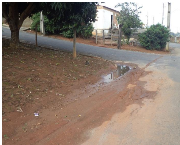
Figura 331 - Vias com sistema de drenagem ineficiente - Bairro Pinheirinho - Rua Paulo Ávila Sales
