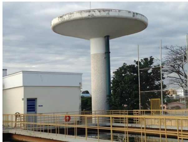
Figura 190 – Reservatório da ETA
