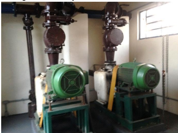
Figura 237 – Conjunto moto bomba EEE 03
