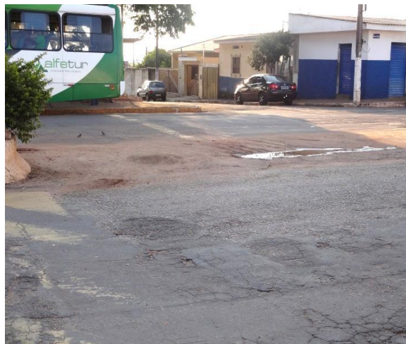
Figura 332 - Vias com sistema de microdrenagem ineficiente (Av. Governador Valadares)
