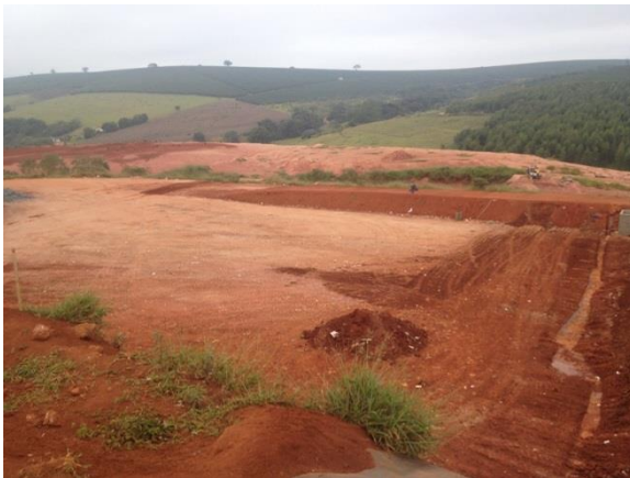
Figura 299 – Área para expansão do aterramento
