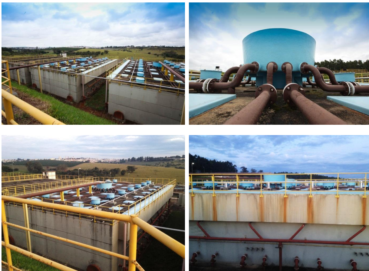
Figura 250 – Vista Reatores UASB
