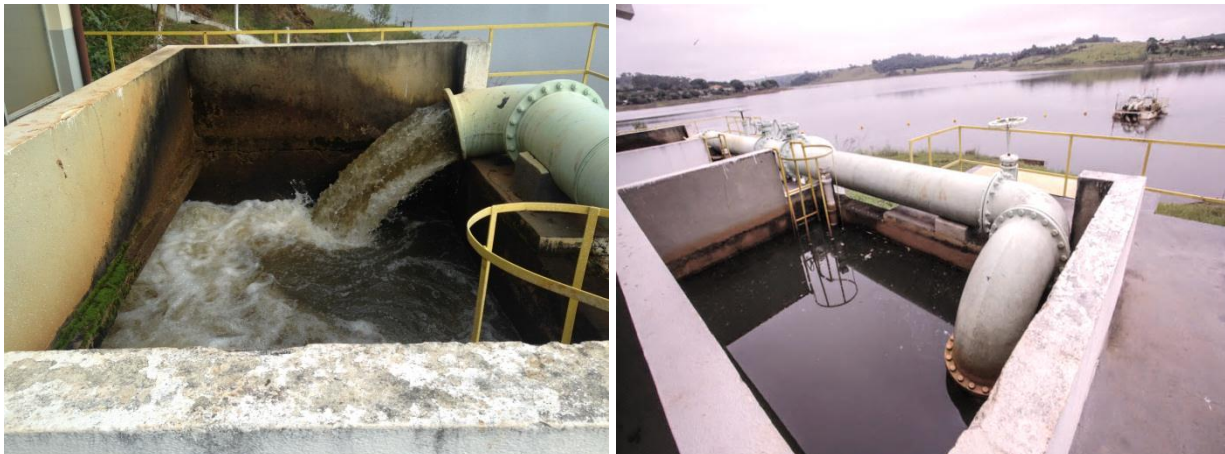
Figura 184 – Rede Adutora de Água Bruta
