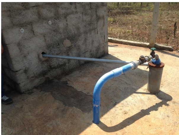
Figura 221 – Poço artesiano (150 m) residência Loteamento Pontal da Esmeralda - Harmonia
