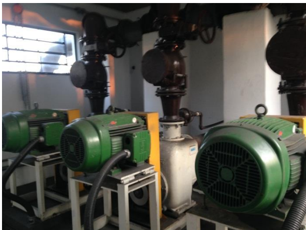
Figura 235 – Conjunto moto bomba EEE 02
