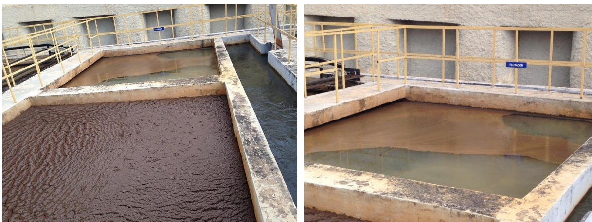
Figura 191 – Flotador da ETA
