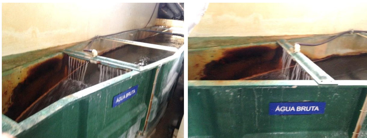
Figura 186 – Calha Parshall de Água Bruta da ETA
