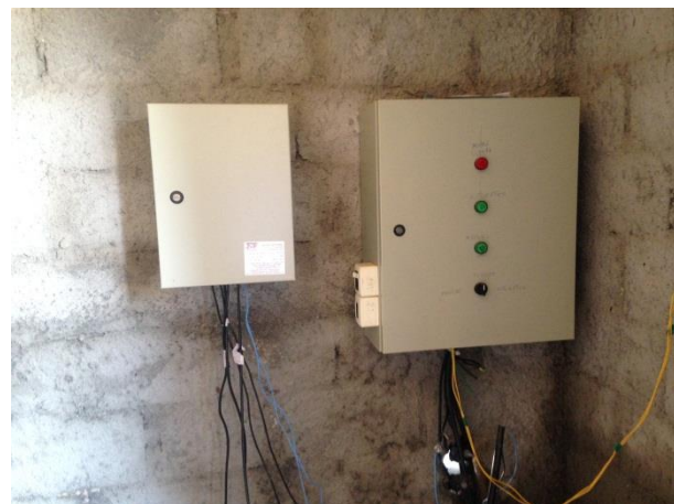
Figura 222 – Painel de controle poço artesiano Loteamento Pontal da Esmeralda
