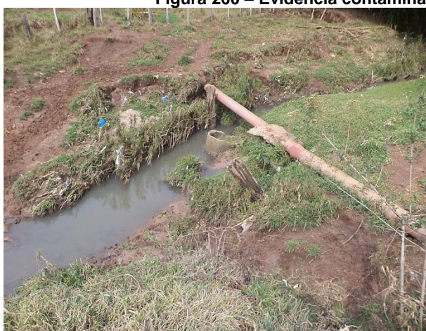
Figura 261 – Lançamento de esgoto córrego do Pântano
