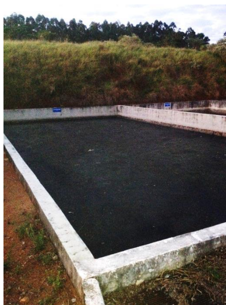
Figura 253 – Leitos de Secagem
