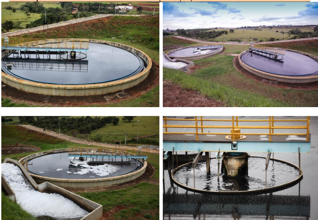
Figura 252 – Decantadores Secundários da ETE
