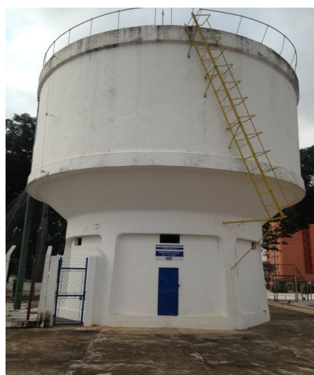
Figura 201 - Reservatório Elevado – REL – 2
